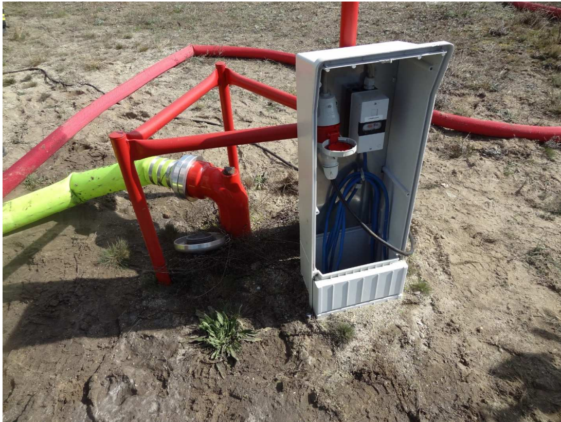
Abb.: Tiefbrunnen, Kopf mit Stromanschluss
